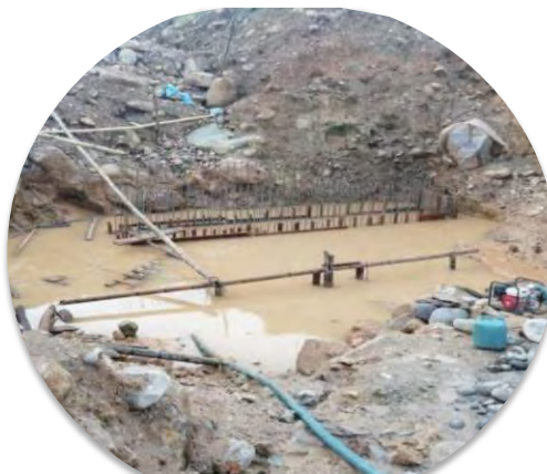
Inundaciones debido a fuertes lluvias
