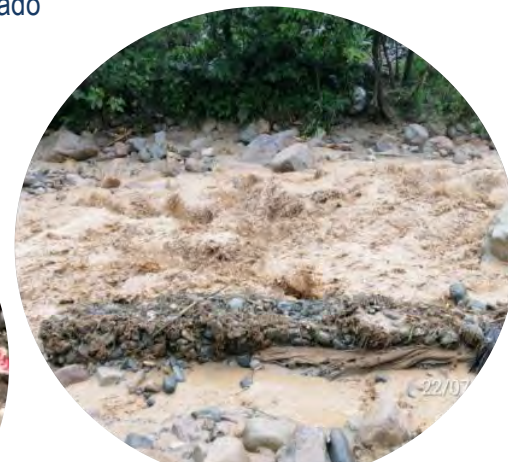
Afectaciones del avance de obra por la creciente del 21 de julio de 2021
