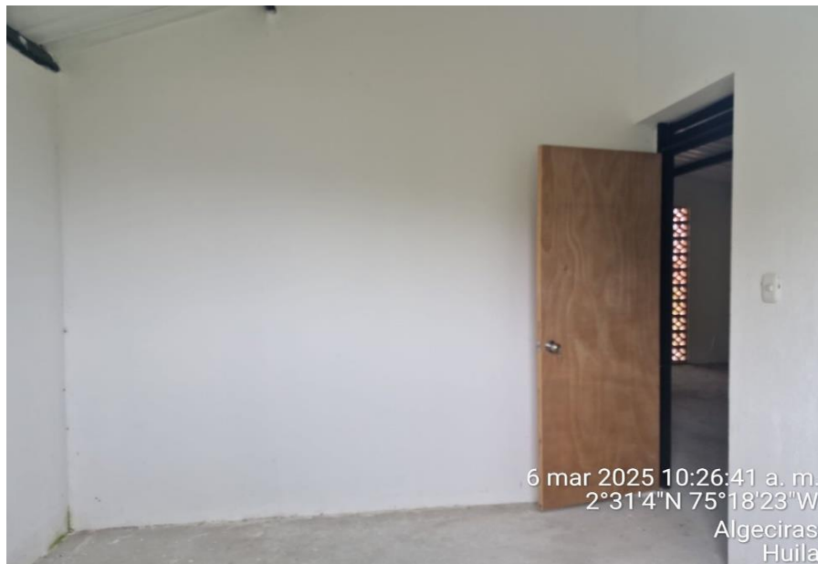
Fotografía No. 4 Interior de una de las habitaciones de la vivienda tipo del beneficiario SERVILIO AVILA VARGAS en la vereda Andes Medios de Algeciras, la cual está vacía, deshabitada y no utilizada
