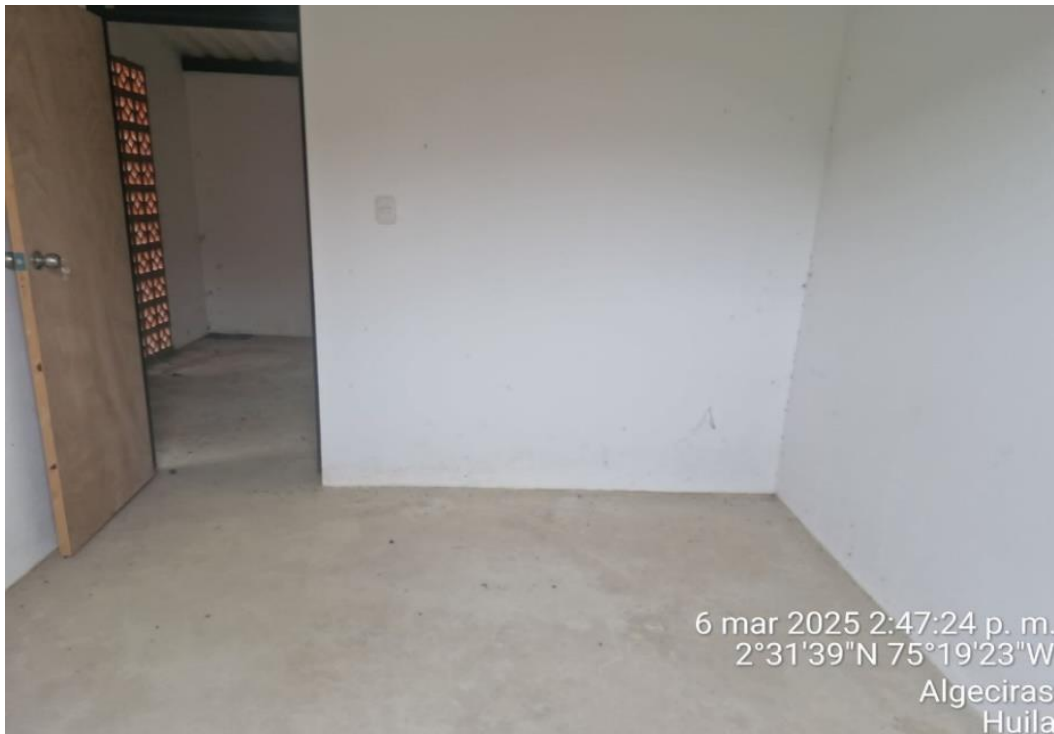
Fotografía No. 8 Interior de una de las habitaciones de la vivienda tipo del beneficiario HERMINZO ZAMORA ORJUELA en la vereda Satias de Algeciras, la cual está vacía, deshabitada y no utilizada.
