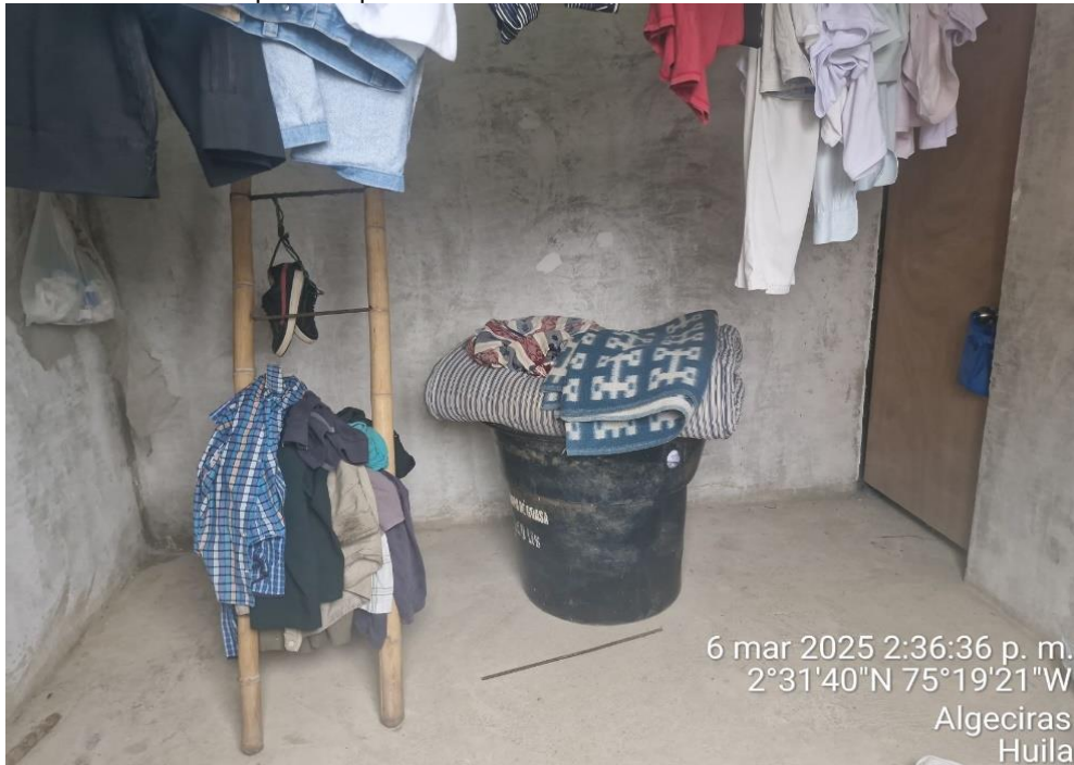
Fotografía No. 13 Grieta vertical en el muro encima de una esquina de la puerta en la fachada posterior de la vivienda de la beneficiaria ANA RUTH FIGUEROA SALCEDO en la vereda Paraíso Viejo de Algeciras.
