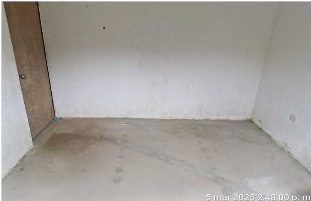
Fotografía No. 2 Interior de la vivienda de la beneficiaria ANATILDE REINA RODRIGUEZ en la vereda Paraíso Viejo de Algeciras, la cual está vacía, deshabitada y no utilizada.
