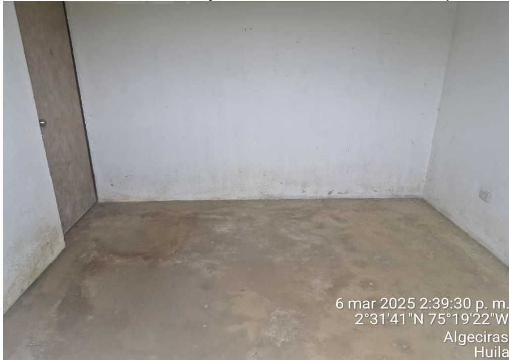
Fotografía No. 7 Interior de una de las habitaciones de la vivienda tipo del beneficiario EVERARDO LONDOÑO en la vereda Satias de Algeciras, la cual está vacía, deshabitada y no utilizada.
