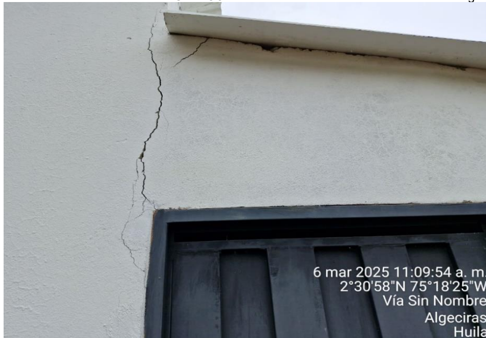
Fotografía No. 14 Agrietamiento en el muro encima de una esquina de la puerta en la fachada posterior de la vivienda de la beneficiaria MARY LUZ RICO RAMIREZ en la vereda Andes Medios de Algeciras.
