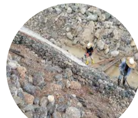
Retiro de colchogaviones del muro de protección 6 afectados por avenida torrencial
