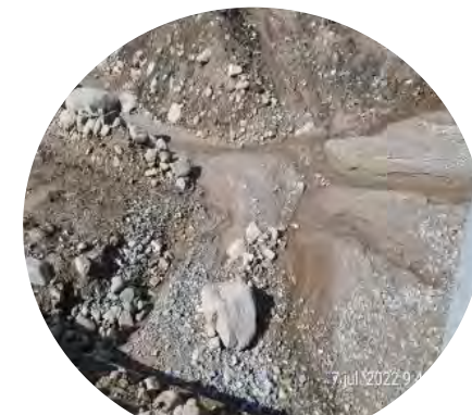
Colmatación de materiales sobre dique 1
