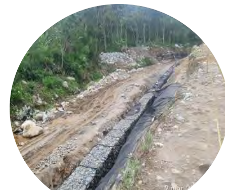
Instalación de gaviones de cimentación y de colchogavión en Muro 2-Quebrada Taruca.
