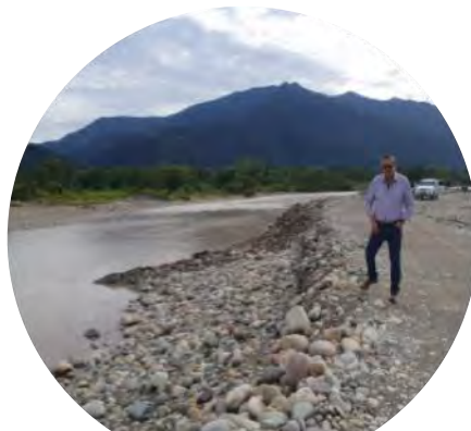
Daño gavión de cimentación por creciente del río
