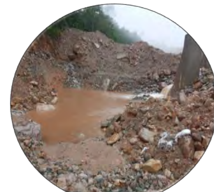
Filtración en excavación
