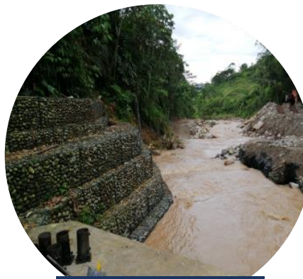
Gaviones laterales margen izquierda
