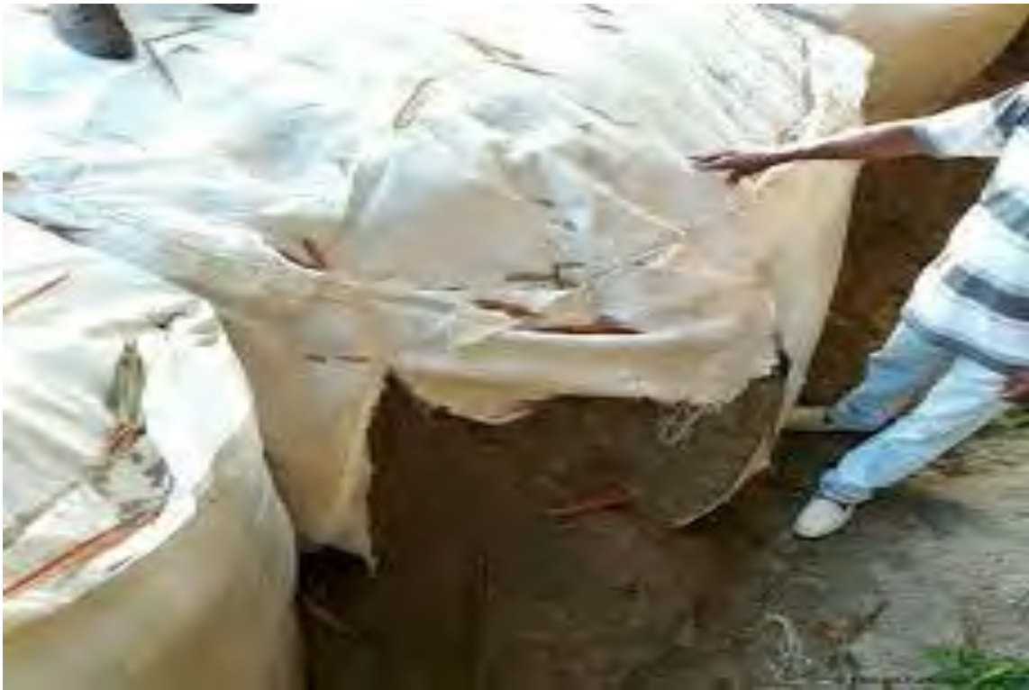
Bandalismo a geocontainer
