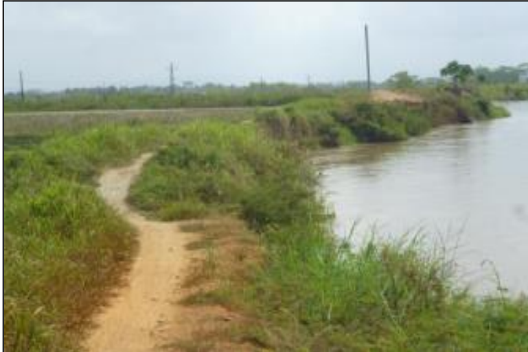
Erosión de orilla - Punto crítico Tramo: Cuestaboba – Pamplona (Norte de Santander)
