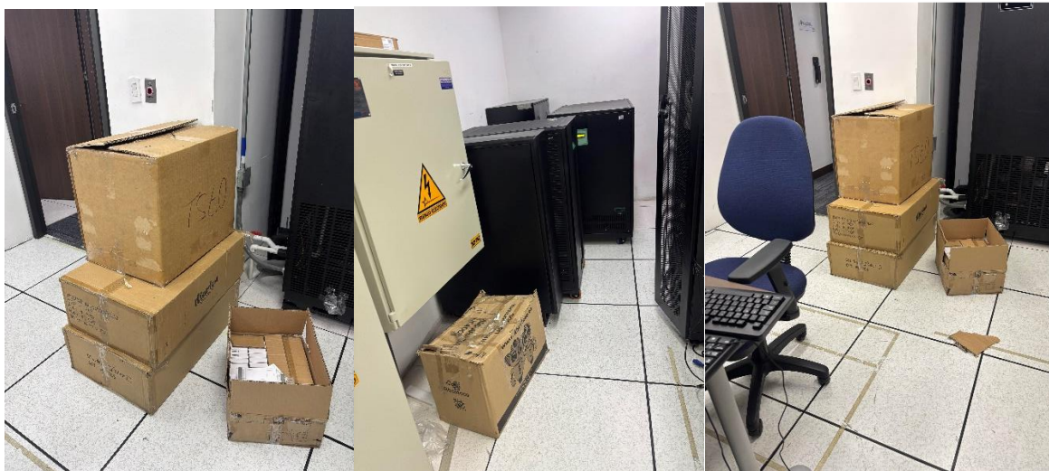
Imagen No. 9 cajas de cartón el cuarto de comunicaciones del 5to piso G4, fuente propia
