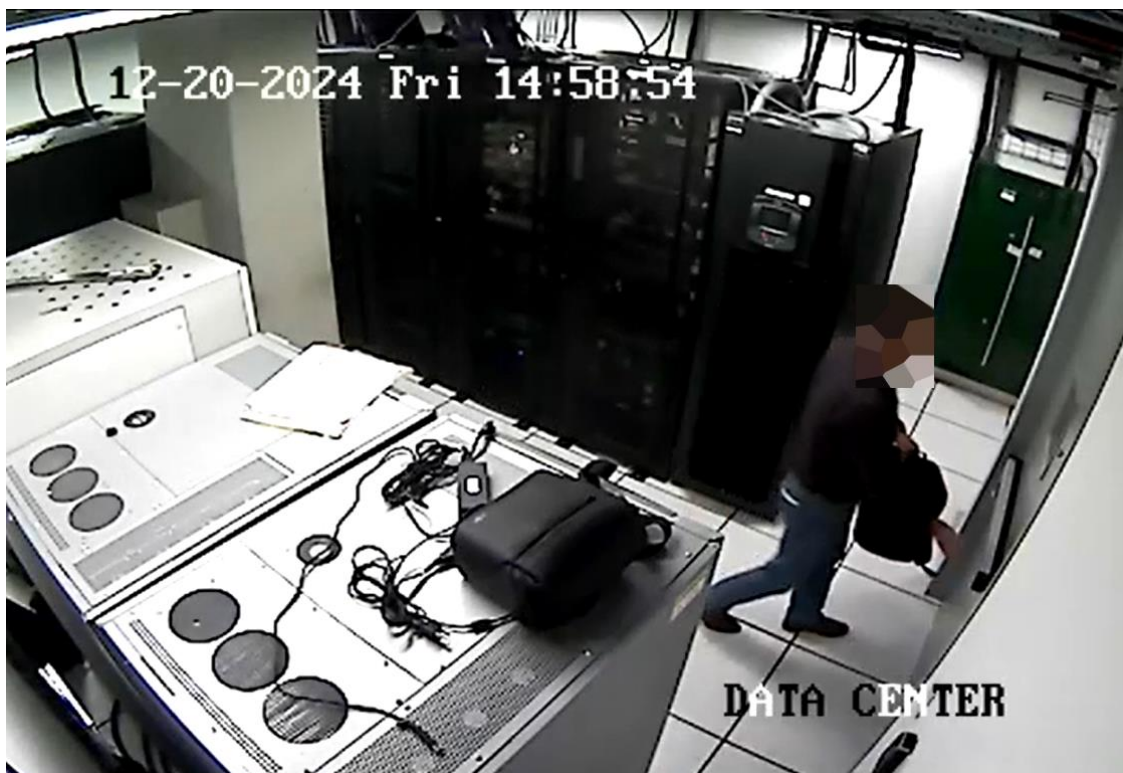
Imagen No 4, de video, cargadores electrónicos, cables y maletín encima de la UPS en el CE, 2do piso G4, diciembre 2024 que no atienden la seguridad y la normatividad, fuente grabaciones del CCTV
