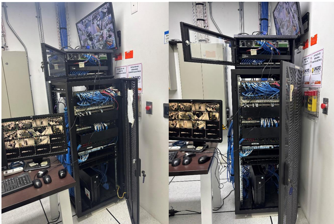
Imágenes No. 6, pach panels abiertos en el CE 2do piso G4 vigencia 2025 que podrían afectar la seguridad del CCTV, fuente propia, CE
