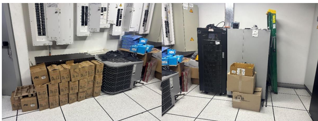
Imágenes No. 5, elementos del CE 2do piso G4 que podrían afectar su seguridad, fuente propia, CE
