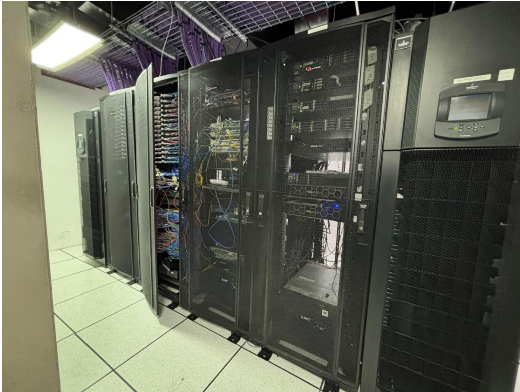
Imágenes No. 10, Patch Panel abierto en el DC 2do piso G4 que podría afectar su seguridad, fuente propia, DC.
