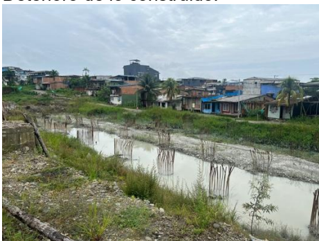
Foto 1. Cimentación tribuna Occidental Expuestos a condiciones climáticas Empozamiento de agua. Deterioro de lo construido.
