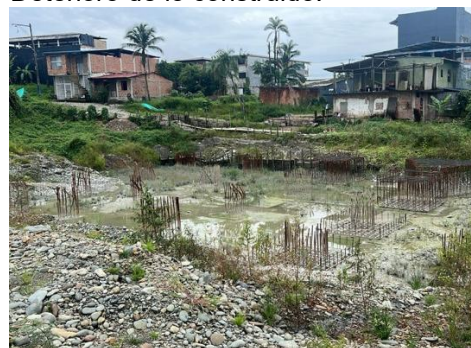
Foto 2. Cimentación tribuna Occidental Expuestos a condiciones climáticas Empozamiento de agua. Deterioro de lo construido.
