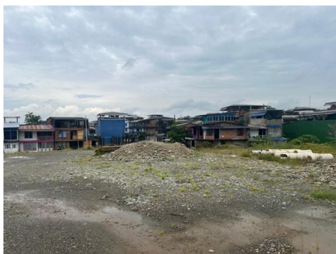
Foto 27. Cimentación tribuna occidental Empozamiento de agua y deterioro de lo construido.
