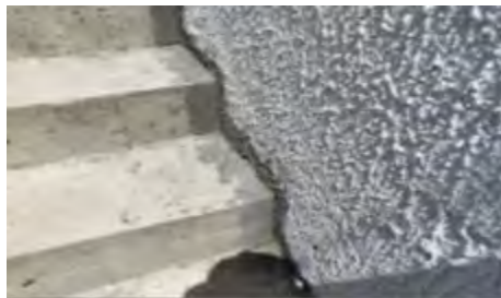
2. Fotografía 2. Dilatación entre escalera y muro.
