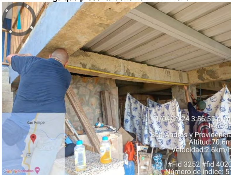
Imagen No. 8- Registro fotográfico de la visita de la CGR del 1 abril de 2024- Viga que presenta deflexión – FID 4020
