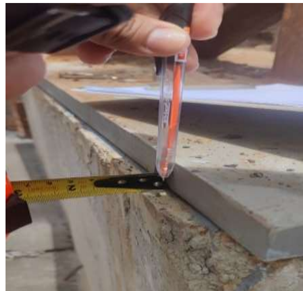
Fotografía N.02. Platina placa base de transferencia de esfuerzo con desplazamiento horizontal con los ejes de fijación de cimentación. Fecha: 29 sept.-22
