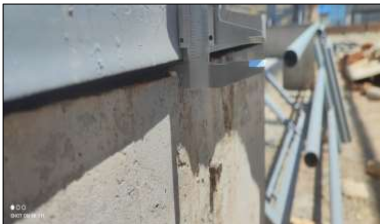
Fotografía N.01. Desnivel entre la transferencia de la platina del pórtico y el pedestal de concreto armado. Fecha: 29 sept.-22
