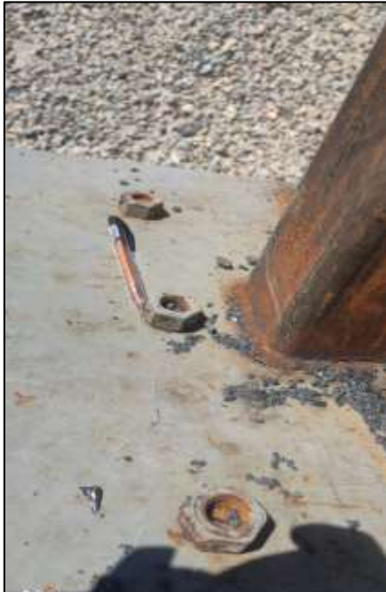
Fotografía N.3. Torque incompleto, pernos de transferencia. Fecha: 30 sept.-22
