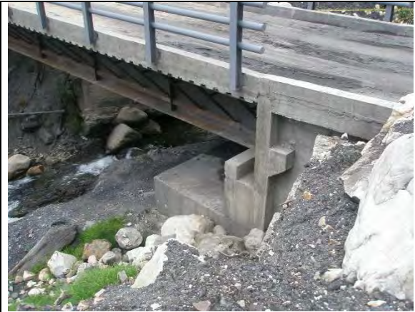
Fotografía 2. Estribos construidos sin obras de protección.
