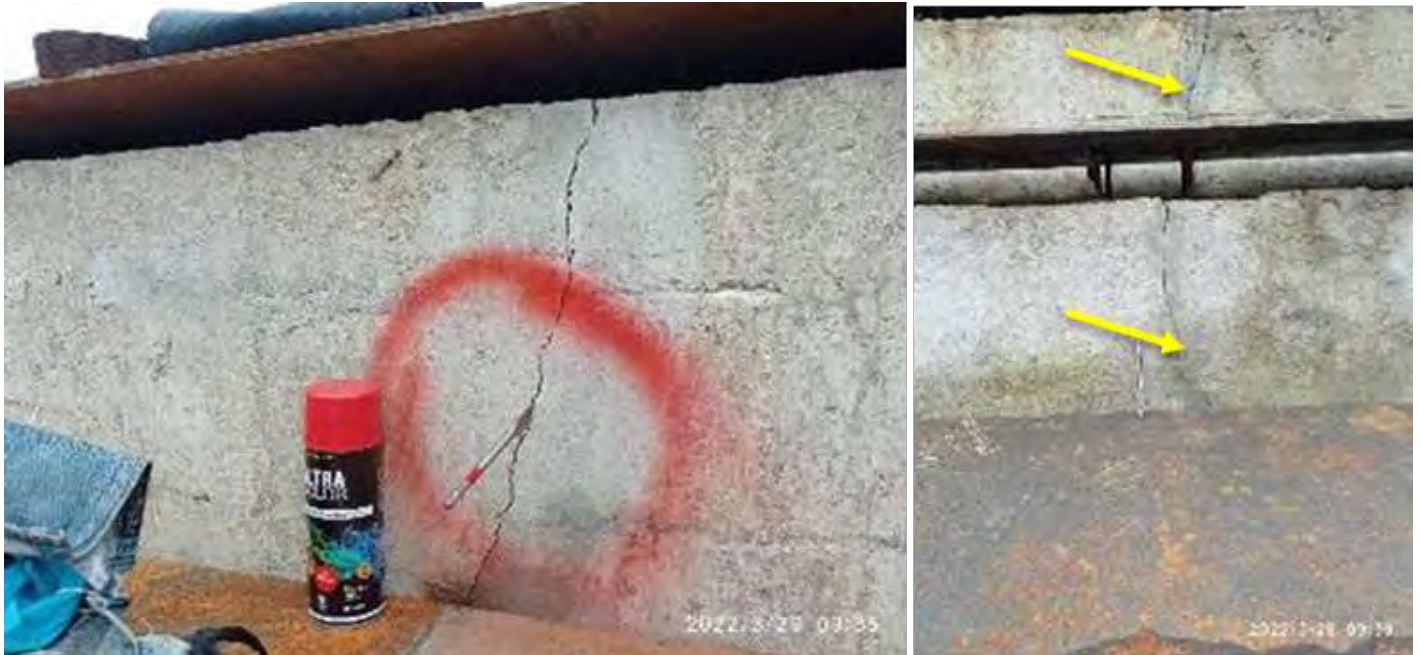
Fotografía Nro. 3 y 4, de izquierda a derecha: Escalas del azud 11 vista en pantalla posterior aguas abajo. Detalle grieta transversal en el cuerpo del Azud 11. Obsérvese que la fractura o grieta está en todos los niveles del cuerpo del azud 11, abertura aproximada 2.5 mm medida con punta de espada. Fuente registro fotográfico del día de la visita de verificación en campo por parte de CGR, el 29 marzo de 2022.
